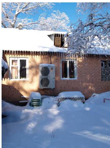
Фото 1. Старая система отопления демонтирована, ZUBADAN работает.
