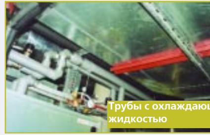
Установленные агрегаты WR2
