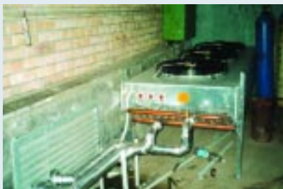
Градирня установлена снаружи возле дома
