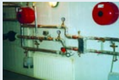
Контур, включающий электрический бойлер, служит для поддержания температуры теплоносителя.
