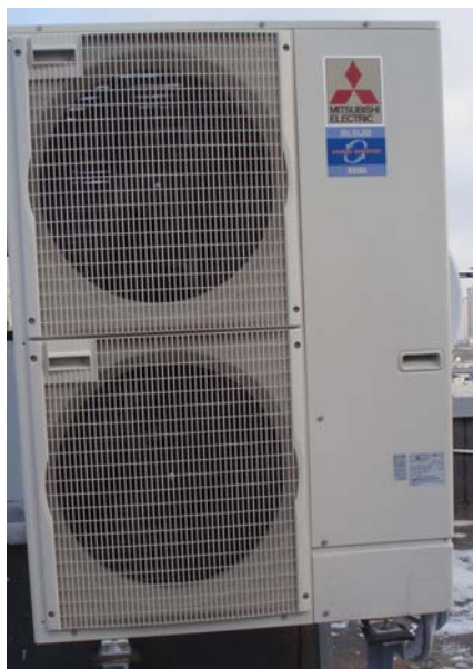
Фото 1. Наружный блок теплового насоса.
